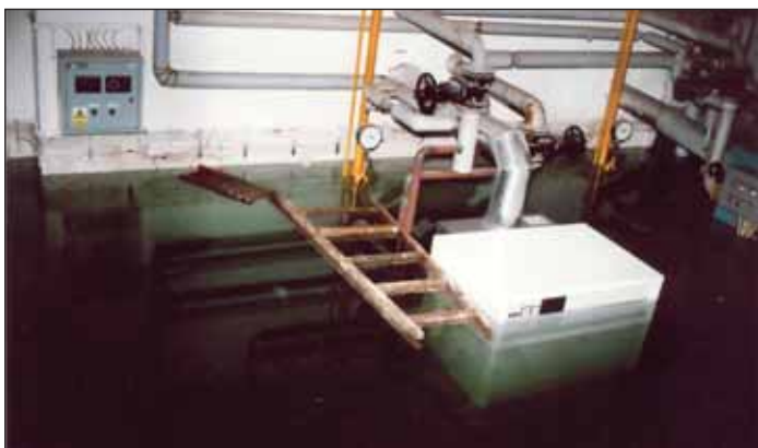
Plynový kotol pod vodou v kotolni obecného úradu (3. jún 2010)
