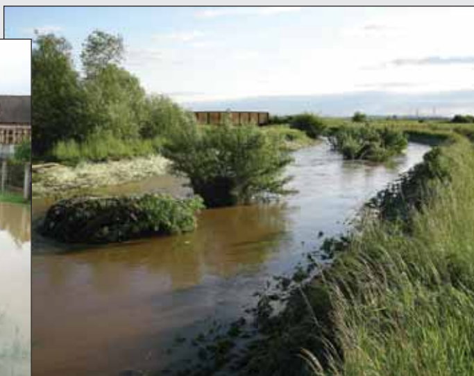
Kríky rastúce v strede potoka pred železničným mostom výrazne spomalili tok a znížili prietok vody pri povodniach a prispeli tak k vyliatiu potoka z koryta v obci. Správca toku zanedbal svoju povinnosť.
